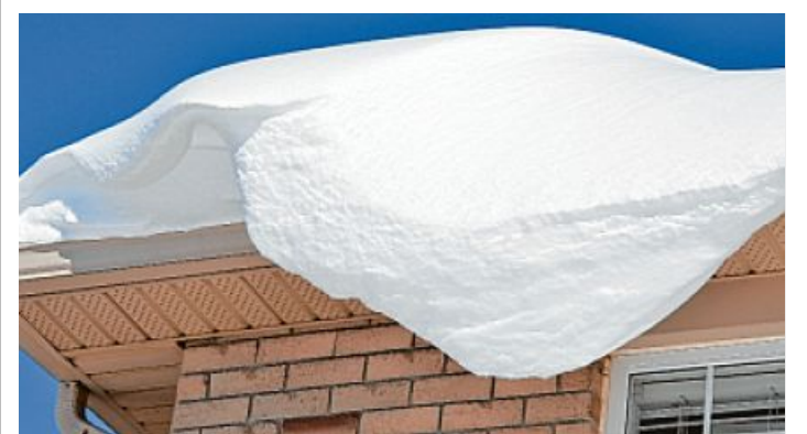
Vom Dach können sich Schneemassen lösen und in der Folge zu Sach- und Personenschäden führen. Foto: iStock
